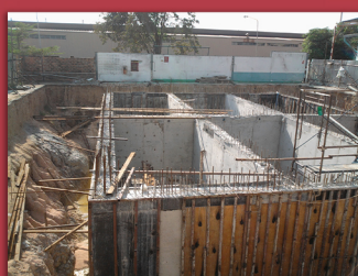
ถังเก็บน้ำใต้ดิน นิคมอุตสาหกรรม เทศบาลเมือง จ.ชลบุรี
